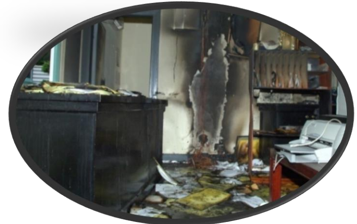
Kejadian kebakaran di Mes Pegawai Bolkiah Garison berpunca dari alat penyambungan elektrik lebih beban - 16 Mac 2012
